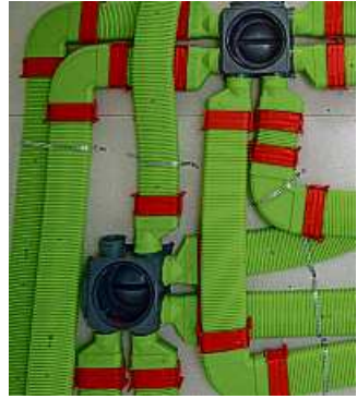
Die Rohre und Filter müssen kontrolliert werden. Foto: dpa
